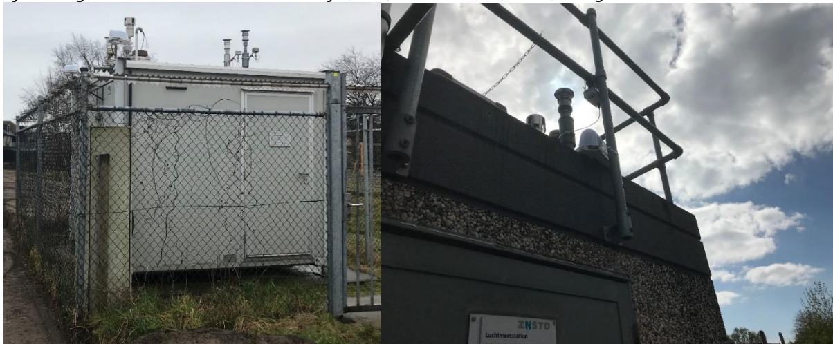
Afbeelding 2. GGD meetstation in Beverwijk (links) en Zaandam (rechts) met geïnstalleerde sensors.
